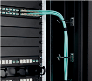
Verticaal in het 19-inch vlak
