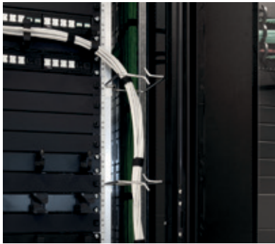
Verticaal in het 19-inch vlak
